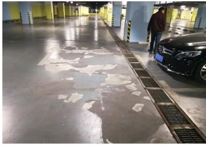
旧地面起壳、破损
