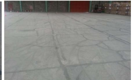
裂缝修补效果
