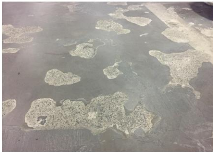
旧地面破损坑洞
