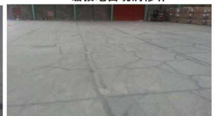
裂缝修补效果
