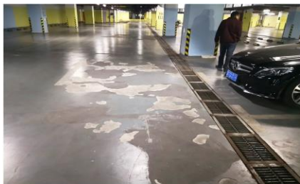
旧地面起壳、破损
