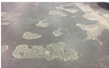
旧地面破损坑洞
